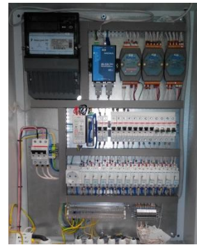
Шкаф управления освещением
